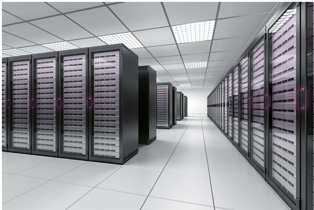
Obrázek 21: Příklad správně vedené serverovny.
